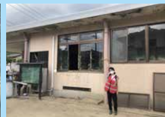
浸水被害を受けた避難所(熊本県)
