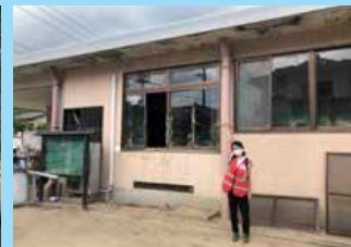
浸水被害を受けた避難所(熊本県)
