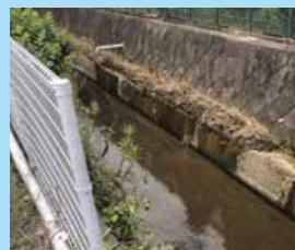
こんな用水路すら氾濫(熊本県)
